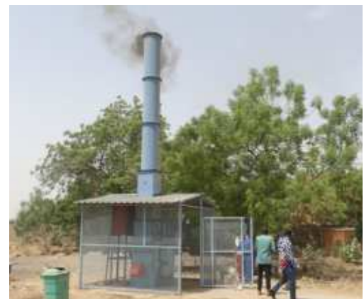
Grâce au jésuite espagnol P. Carlos et son réseau d'Amis-Entreculturas, le CHUBS a pu remettre en marche son incinérateur
