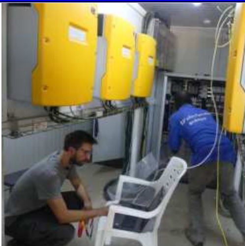
Un technicien de TTA avec un électricien du CHU-BS dans la salle technique de la centrale solaire
