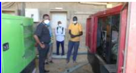
Le P. Mathieu Ndomba, Provincial des jésuites constatant la vétusté des groupes électrogènes
