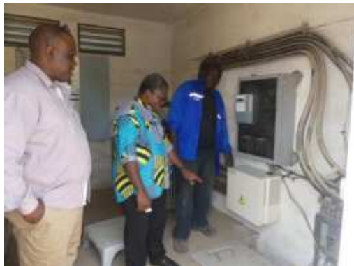
L'équipe de MED avec le DG du CHU-BS après l'installation de la batterie de compensation
